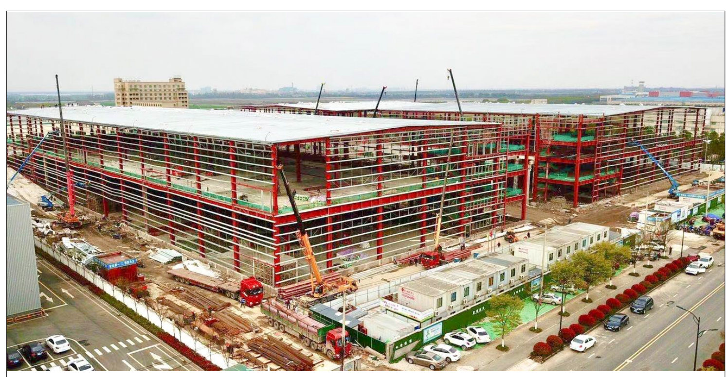
杭州帝通低温科技园项目位于钱塘芯谷,总投资逾5亿元,计划新建1幢低温车间及分拨用房,和2幢冷库及副用房(主体为钢结构体系)以及门卫设备用房等,项目达产后,预计年产营养保健食品2000吨,航空食品8000吨,加工和储存转运饰品、化妆品等其他货物2万吨。目前项目正在主体施工中。 记者 方波 摄
